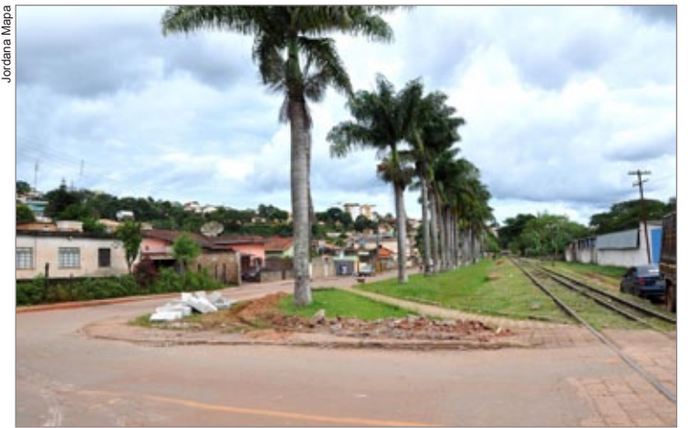
Alargamento está sendo feito no cruzamento entre as Ruas Belo Horizonte e Emídio Quites
