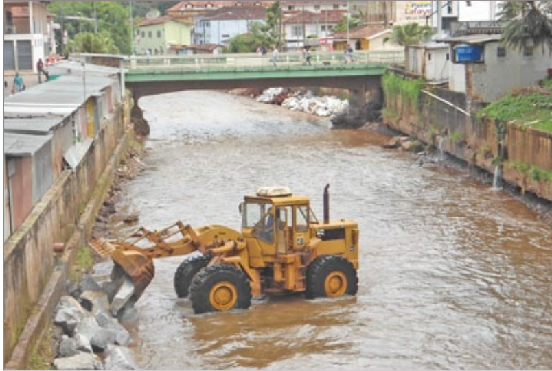
Colocação de pedras busca proteger os muros de arrimo e as casas à beira do Ribeirão do Carmo
