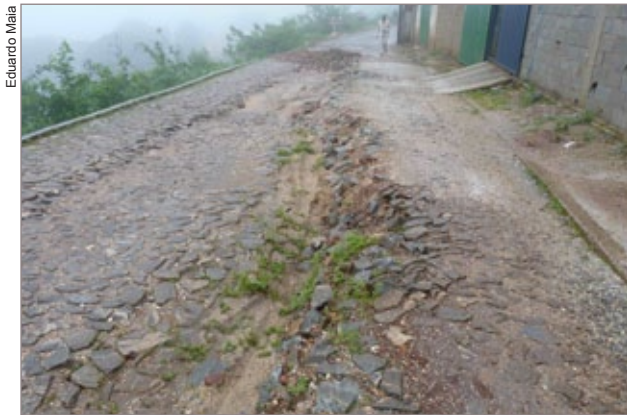
Afundamento da Rua João Goulart, no Taquaral
