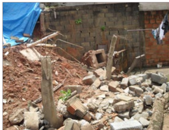
Muro de arrimo demolido por deslizamento no Monte Verde
