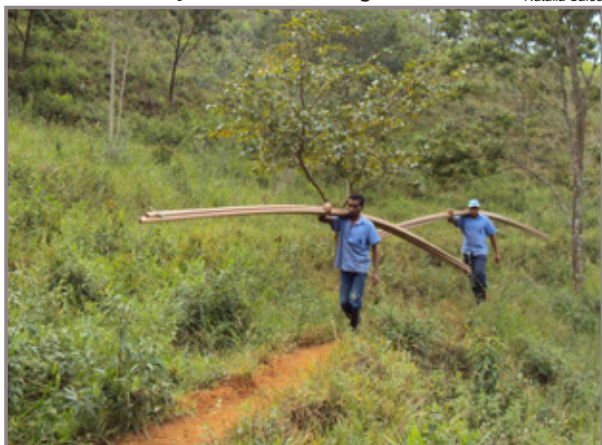
Funcionários carregam tubos para redes de água na zona rural de Mainart
