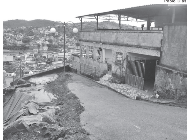
Espaço estava parcialmente comprometido devido a uma erosão causada pelas chuvas do início do ano
