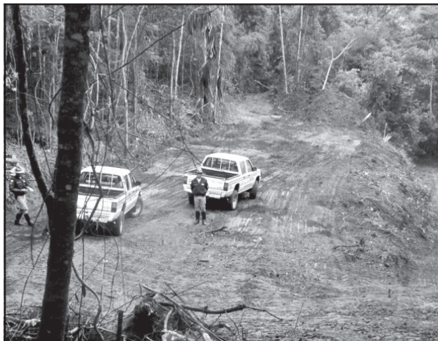
Lavradores agiam na área de preservação por meio de escavadeiras e estradas abertas na mata
