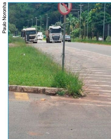
Embora o período noturno seja o de maior preocupação, de dia já se pode observar algumas carretas estacionadas no local. Colisões já ocorreram no local
