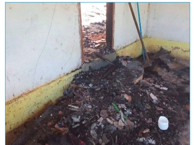
Imóvel ficou completamente destruído após incêndio
