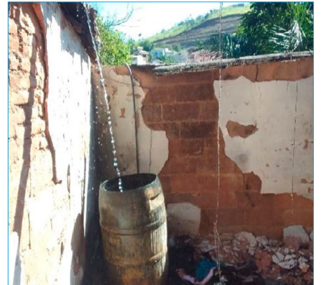
Parte estrutural foi comprometida após possível curto-circuito
