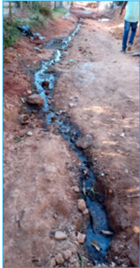
Vazamentos são frequentes no bairro devido a rede ser antiga e superficiais
