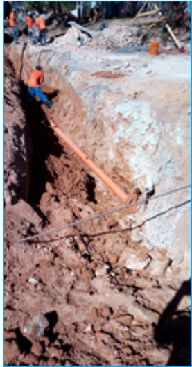
Mais de 1.500 metros de rede de esgoto será substituída em todo bairro
