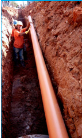
Parceria entre SANEOUROS e Prefeitura de Ouro Preto promove a substituição da rede de esgoto da Chapada, em Santo Antônio do Leite
