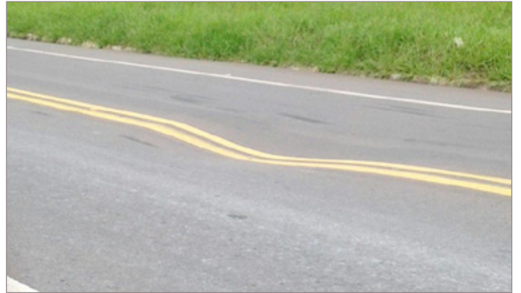
Motoristas perceberam o afundamento da via na noite do dia 29 de dezembro
