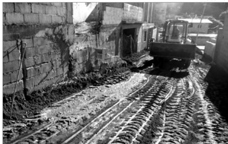
Encanamento quebra, e provoca o vazamento de água
