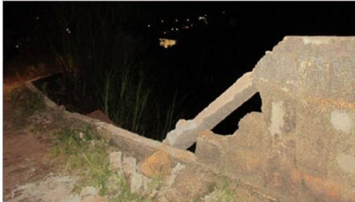
Muro de segurança foi derrubado para facilitar a visão do tráfego de viaturas no local
