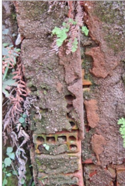
Água vaza pelas perfurações
