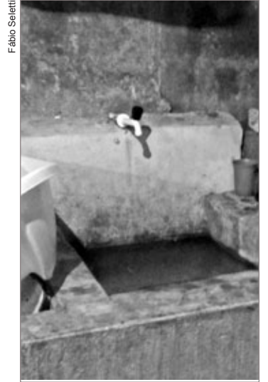
Gislene reclama do "tanque entupido"
