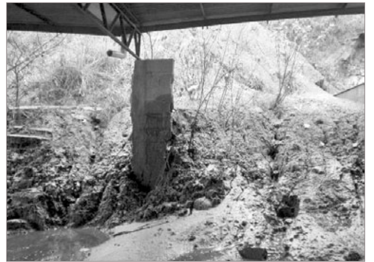
Muros não suportaram o deslizamento no início de 2009
